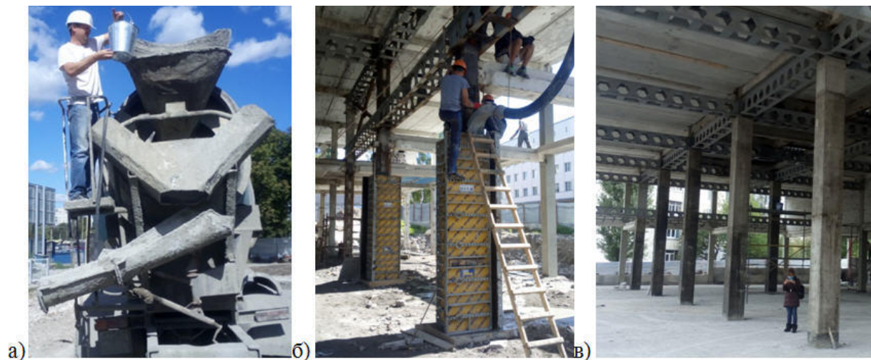
Рис. 2. Бетонирование колонн из самоуплотняющегося бетона: а) второй этап введения суперпластификатора; б) бетонирование усиления нижней части колонны; в) готовые колонны после усиления
